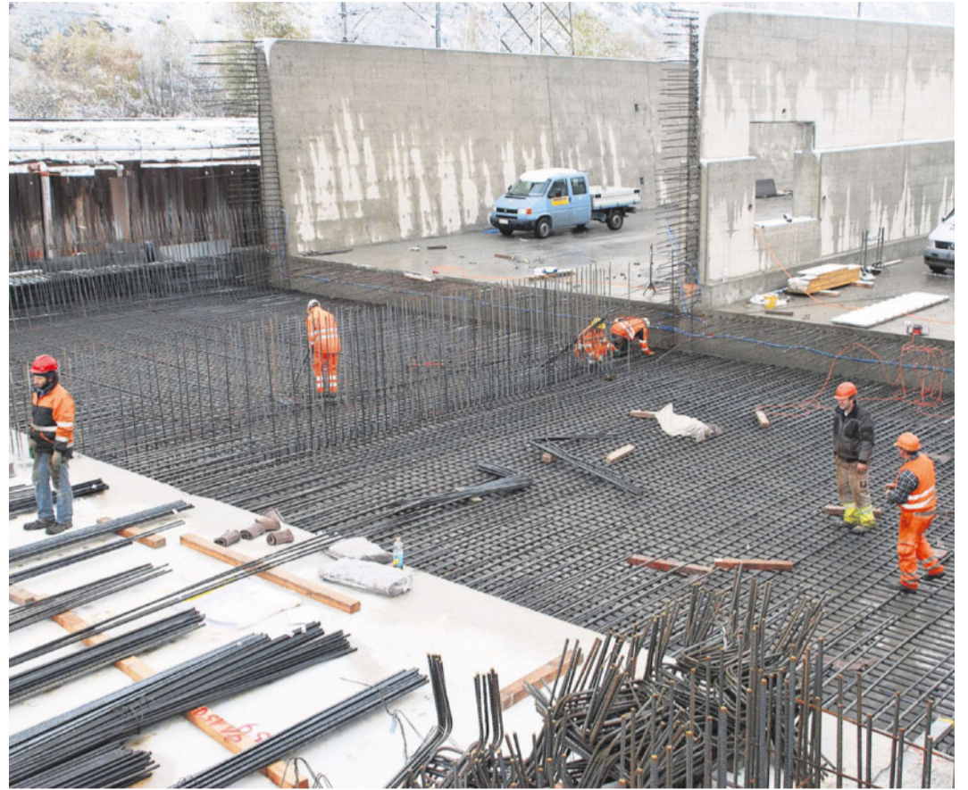
Ultimo. Arbeiter armieren das letzte Stück Bodenplatte des gedeckten Einschnittes Turtmann, das am kommenden Dienstag betoniert wird. FOTOS WB
